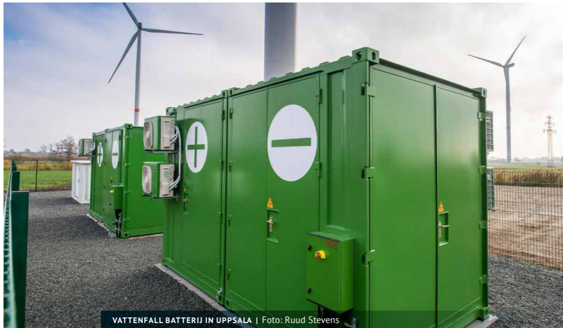
VATTENFALL BATTERIJ IN UPPSALA | Foto: Ruud Stevens
